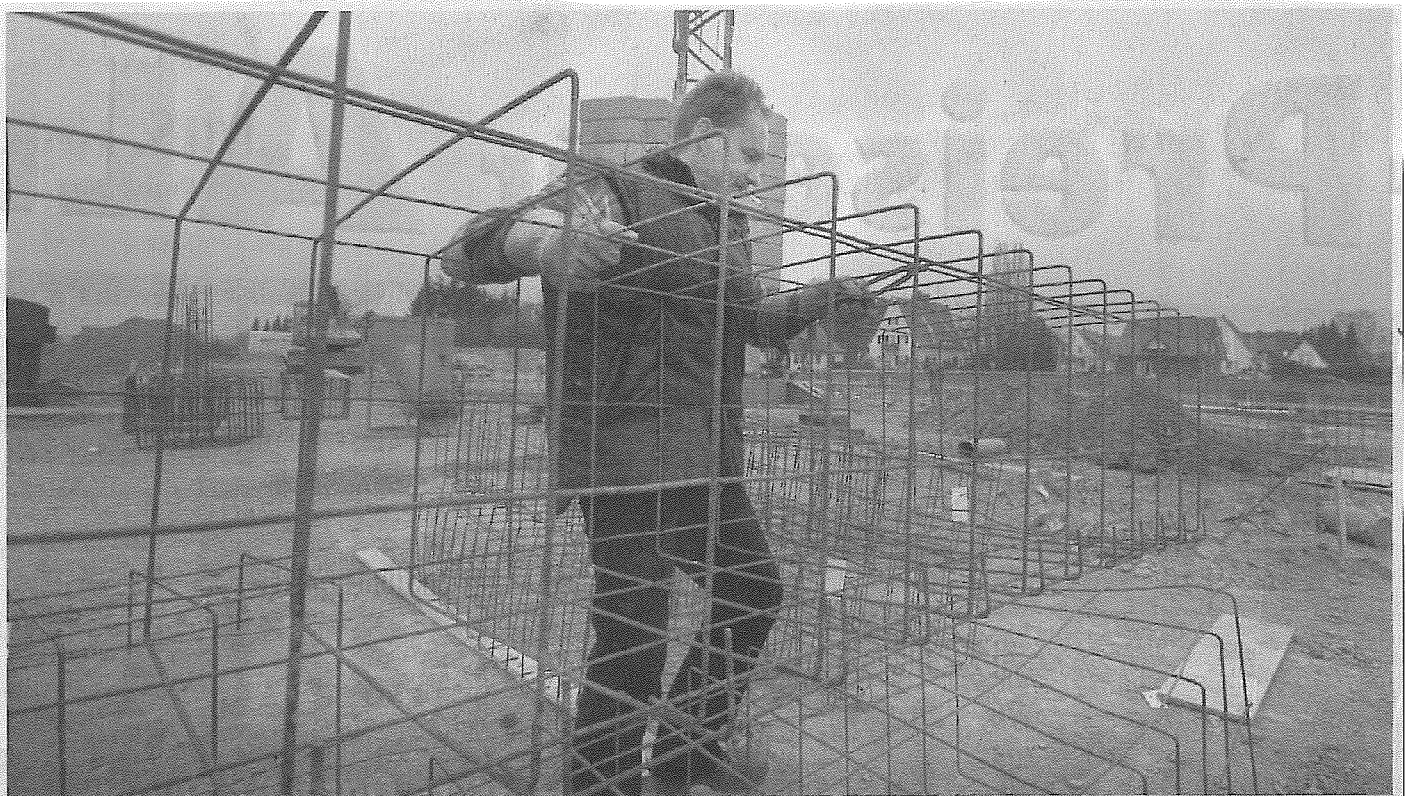
Die Arbeit geht voran: Jürgen Grabow trägt einen Gitterkasten, der in die Fundamente des neuen Gebäudes am Drosselweg eingearbeitet wird. Das Eisengeflecht dient der Stabilität des Fundamentes.
